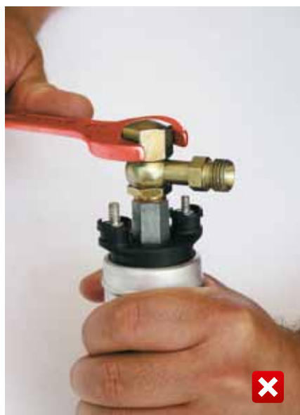
Рис. 70: Неправильный монтаж: затягивание без контрения
